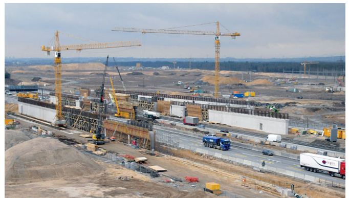
Bild 5. Rollbrücke Ost 1, Bau der Wandscheiben Fig. 5. Taxiway Bridge East 1, construction of the wall panels
